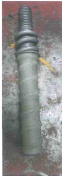
Perno de anclaje de placa Thyssen Krupp
